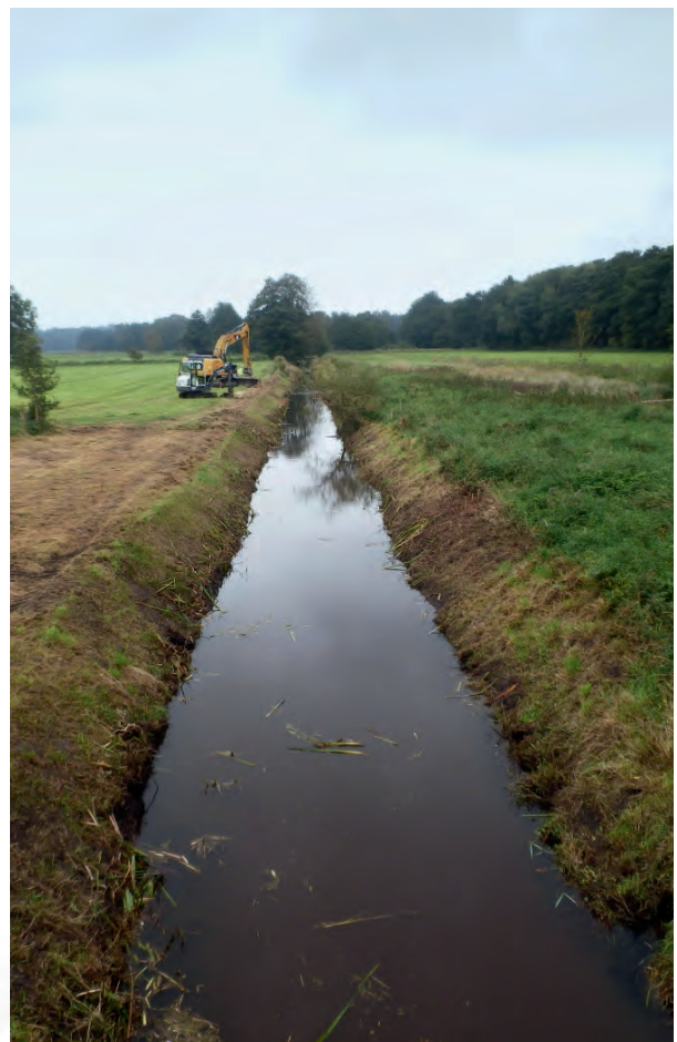
Vor der Maßnahme: einheitliches Trapezprofil und wenig Strukturen
